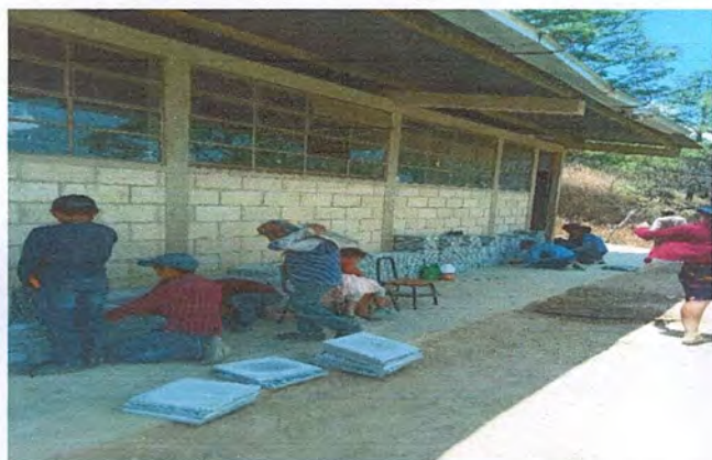
Foto 3: SE ESTAN MEJORANDO LOS VALCONES Y VIDRIOS.
